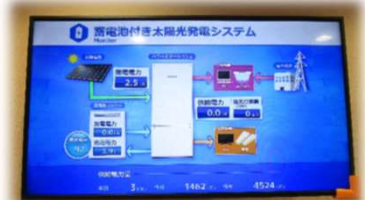
発電システム稼働状況
